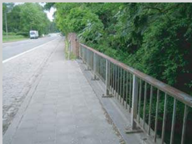
Une rembarde métallique en mauvais état.
