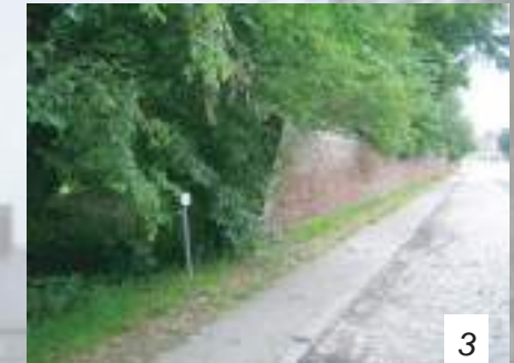
3 Le mur est par endroits en mauvais état.
