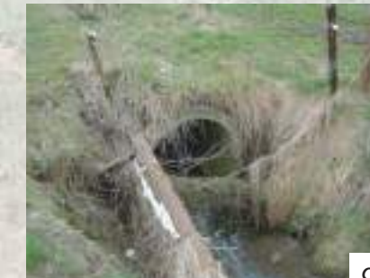
9 Les canalisations du ruisseau sont en mauvais état
