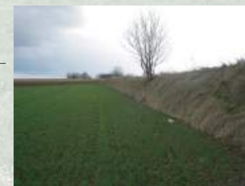
Situation actuelle du talus.
